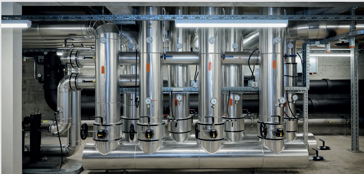
Energiezentrale Haberfeld, Vaduz (Fernwärme-Verteiler)
